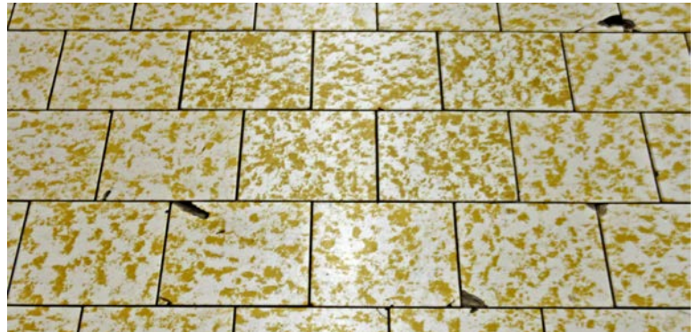
Abplatzungen an den Kanten der keramischen Beläge des Rüttelbodens
