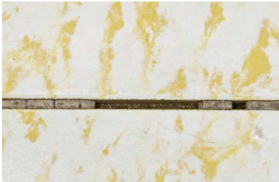
Ausbrüche an den Fugen eines Rüttelbodens
