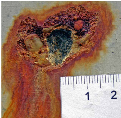
Abb. 6: Braunverfärbungen aufgrund zersetzlicher, eisenhaltiger Gesteinskörnungen (Pyrit)
