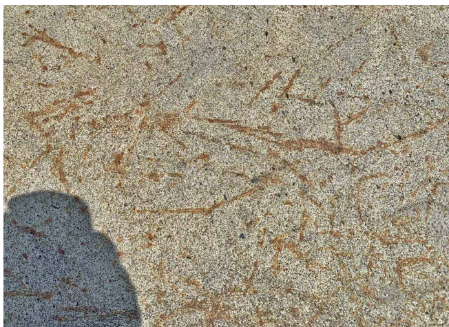
Abb. 11 a+b: In der Betonoberfläche auftretende, rostende Stahlfasern
