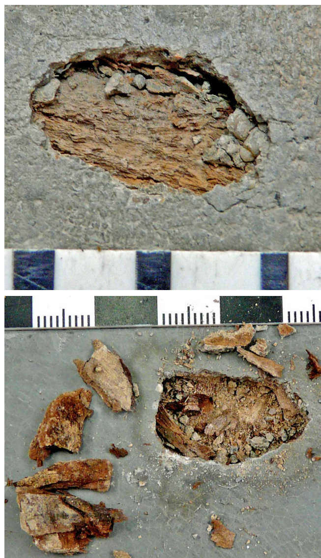
Abb. 3 a+b: In einem Industrieboden enthaltene Holzeinschlüsse
